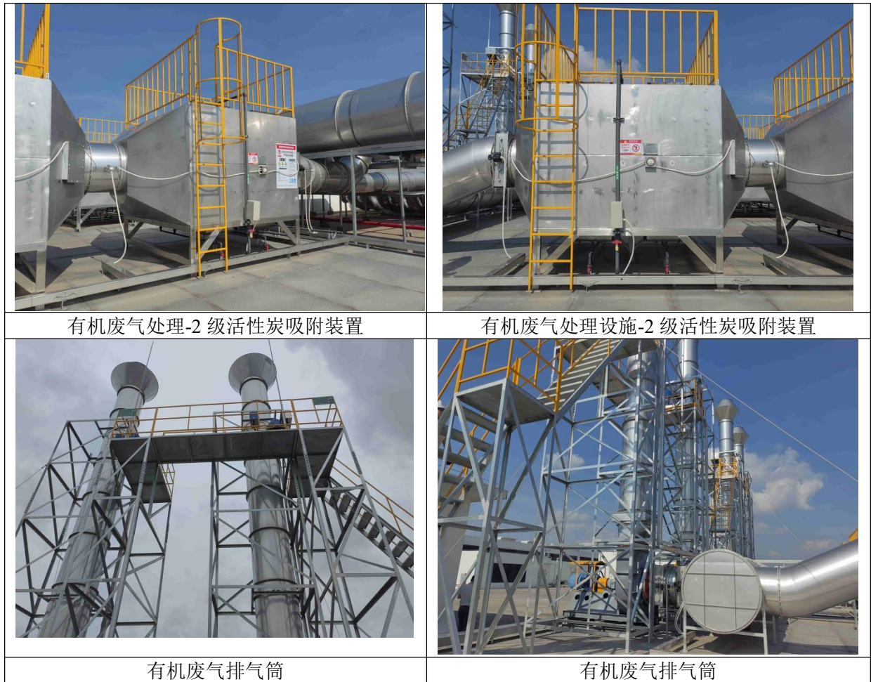
图 4.1-5 废气治理设施照片
