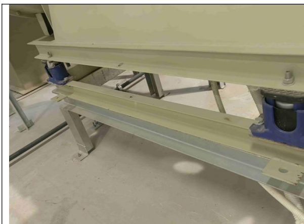
风机减震措施
