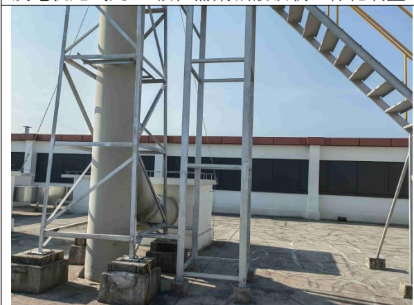
废水站废气排气筒
