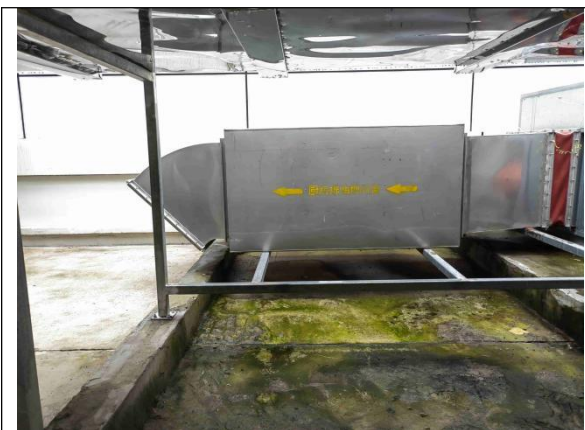
食堂油烟排放口
