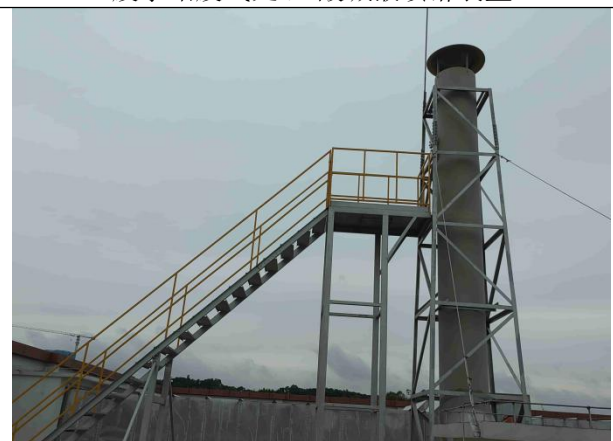
废水站废气排气筒
