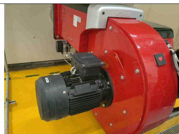
锅炉废气处理-低氮燃烧器
