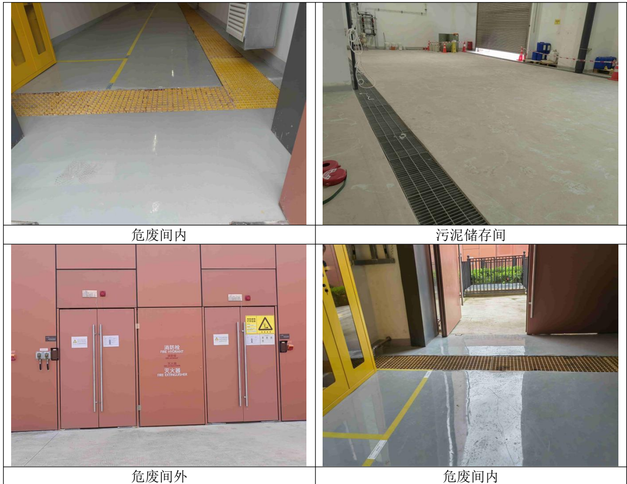
图 4.1-7 固（液）体废物治理设施照片
