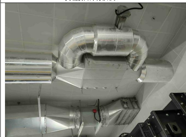
发电机尾气处理-颗粒捕集碱液吸收一体化装置
